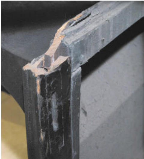
Abb. 65: Die Fenstersäule ist auf Höhe der Fensterunterkanten fast glatt abgerissen und verlorengegangen. Im unteren Bereich ist das Schließblech für den Türriegel zu sehen.
