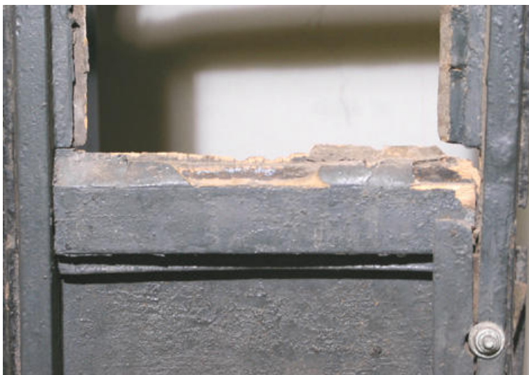
Abb. 91: Innerer, unterer Fensterfalz der linken Türe. Durch großflächige, nachträgliche Überkittungen ist das getreppte Profil des Rahmens nur noch an Fehlstellen des Kitts zu erkennen.
