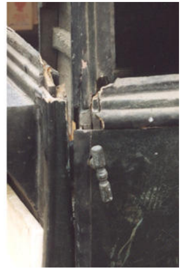
Abb. 71: Der vordere Rahmenfries der linken Türe ist auf Höhe der Fensterunterkante eingerissen.
