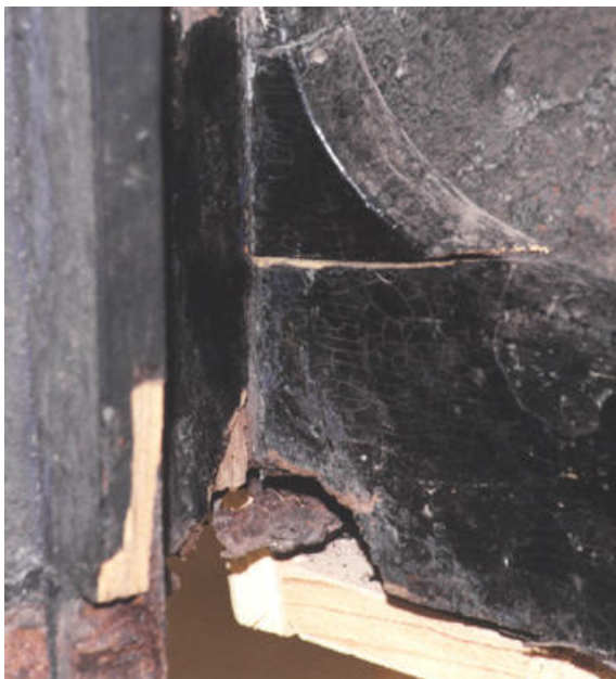
Abb. 63: Offene Fugen und von Pilzen zerstörtes Holz am linken Türschweller.
